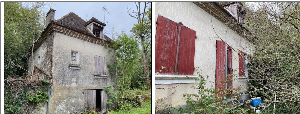
Maison à l'abandon
