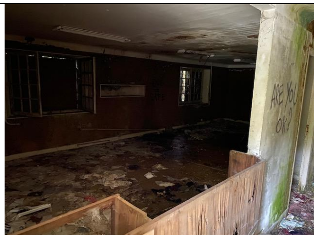
Intérieur très dégradé
